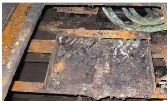
Fig.3. Cablurile de forță de la EMT 5
